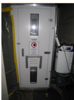
Premier compartiment du sas de décontamination
