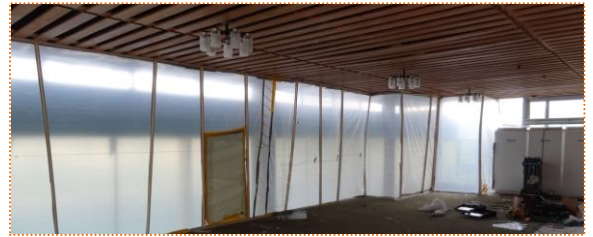
Confinement autour de la piscine
